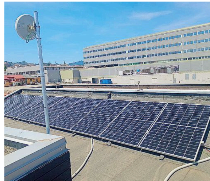
Impianto fotovoltaico al Fondo Saccà
